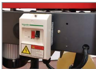
INTERRUTTORE GENERALE MAIN POWER SWITCH
