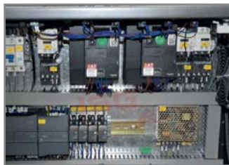
QUADRO ELETTRICO GESTITO DA PLC MACHINE CONTROLLED BY PLC
