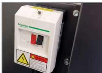
INTERRUTTORE GENERALE MAIN POWER SWITCH
