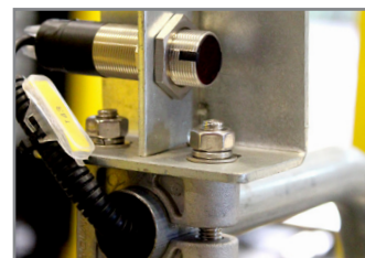
FOTOCELLULE RILEVAMENTO PALLET PALLET DETECTION PHOTOCELLS
